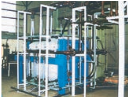
リサイクル設備
