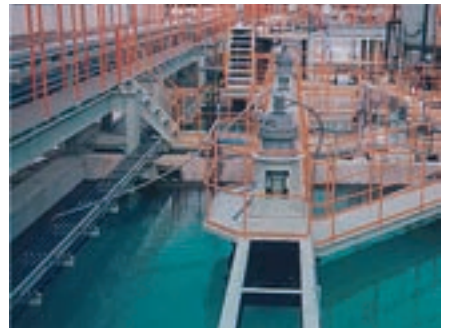
廃水処理設備
